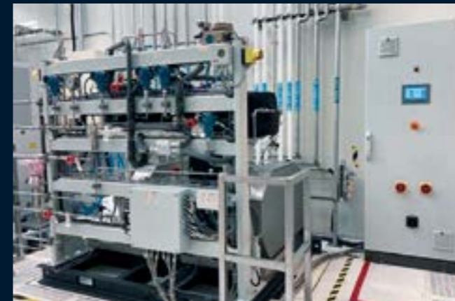
Instrumentengestell und Steuerschrank zur Regelung der beiden Metallmembrankompressoren vom Typ MV3 bei unserem taiwanesischen Kunden.
