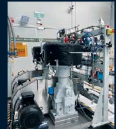
Im Bild gut zu erkennen: Die (schwarzen) Isolierungen der elektrisch beheizten Ventilköpfe und die Anordnung der redundanten Verdichterstufen.
