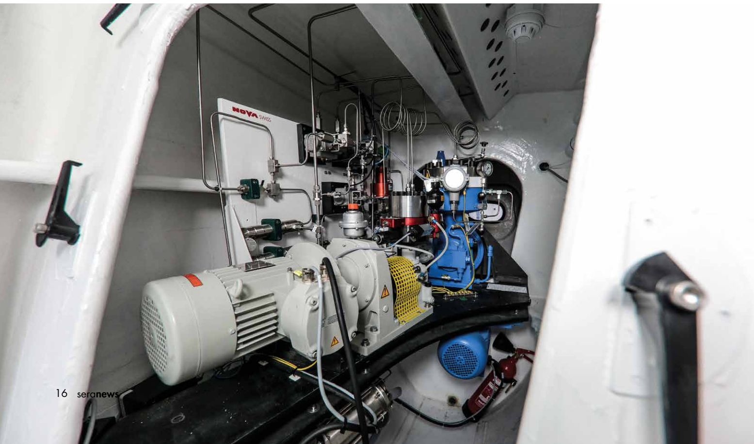
sera Kompressor (Blau) im seitlichen Maschinenraum des Energy Observers
