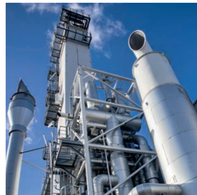
Moderne Luftzerlegungsanlage von SWF am Standort in Bielefeld.
