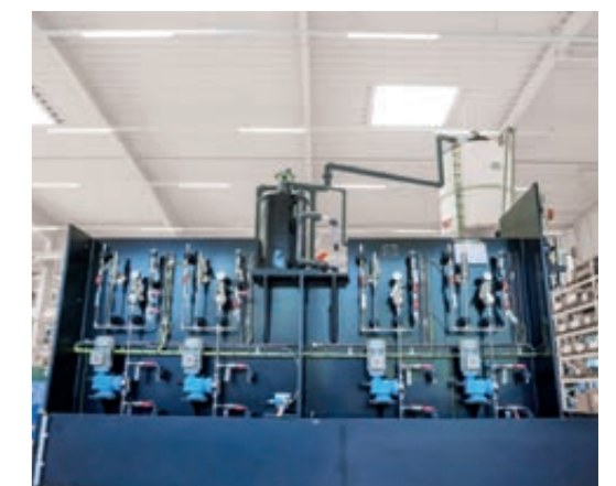
Rückseite der Dosierstation für Natronlauge.
