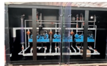
Dosiergerät für Natriumhypochlorit: Es besteht aus drei Dreifachpumpen (zwei in Betrieb, eine in Reserve). Das Natriumhypochlorit wird zur Wasserdesinfektion in das Meerwasser eingespritzt, bevor dieses in den Umkehrosmoseprozess gelangt.
