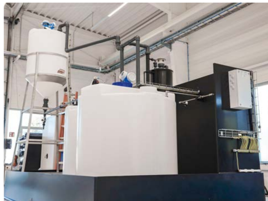
Verdünnungsstation für Ammoniak mit Vorlagetanks: Verdünnung von 25%-igem Ammoniak zu 0,5 bis 2%-igem Ammoniak und Lagerung in zwei Vorlagetanks.
