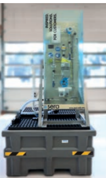
Dosierstation für Natronlauge: Entnahme des Medium aus bauseitigen IBC und Dosierung in den Hochdruckbereich.
